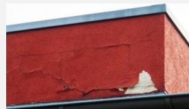
Südseite einer Hauswand mit Hitzeschaden (Foto: K.PLAN)
